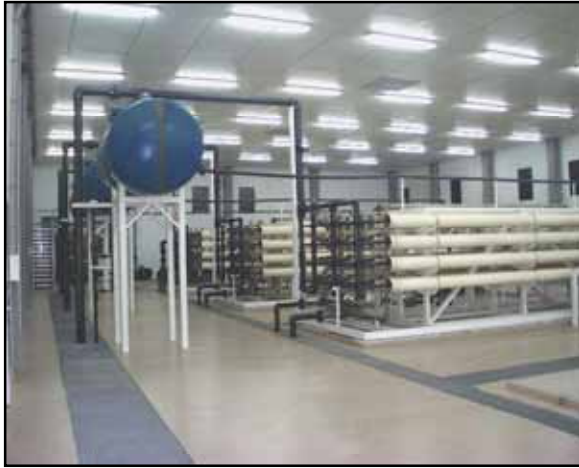
Figura 1: Sala de ósmosis de la desaladora.
